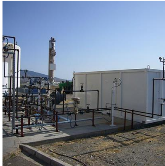
Abbildung 3: Latentspeichermodul mit 100 kW, Beladung mit solar erzeugtem Dampf. Binäre Nitratsalzmischung als Speichermedium, Phasenwechsel bei 220 °C
