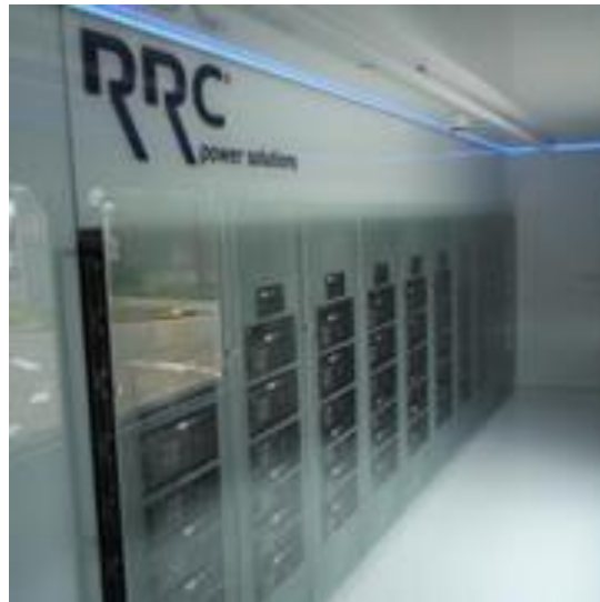
Abb. 3: Stromspeicher-Container als Pufferspeicher und zur Notstromversorgung für kommunales Areal im Saarland der RRC power solutions GmbH; Bildquelle: RRC power solutions GmbH
