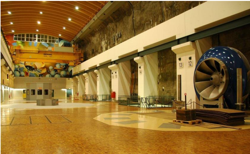
PSW Goldisthal: Maschinenkaverne (Quelle: Vattenfall)
