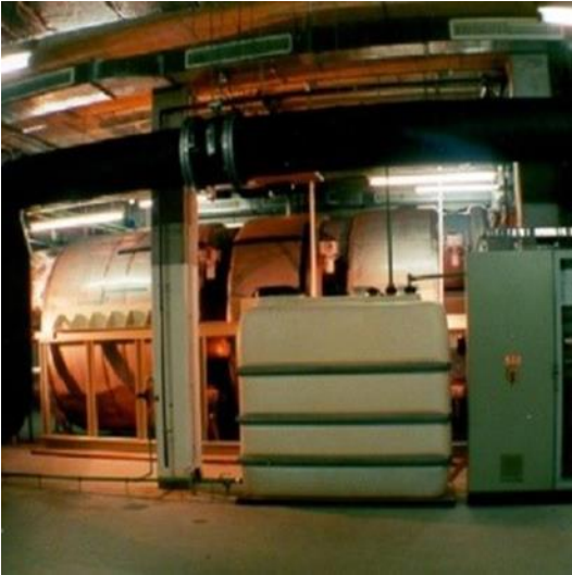
Abbildung 2: Sorptionsspeicher mit Zeolith im Fernwärmenetz der Münchner Stadtwerke
